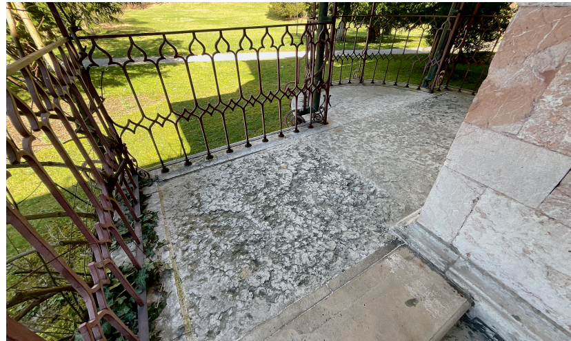
Abb. 4: Detail der nordseitigen Terrasse (Nebeneingang), Zustand des entstehungszeitlichen, nicht getauschten Bodens aus grauem Pötschen Marmor
